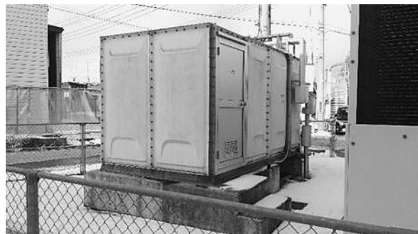
写真：FRP製受水槽
